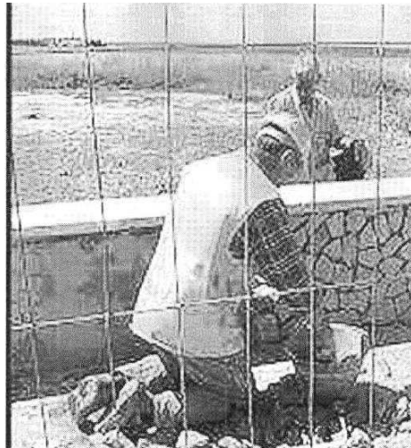
Operai al lavoro in un cantiere nel Ragusano. In basso piazza del Popolo, oggetto di eterni lavori di restyling ma non ancora operativa, in pieno centro nel capoluogo.
